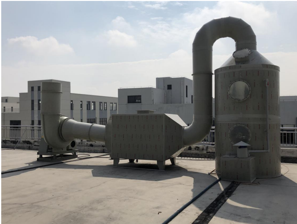
图 3-2 上胶、烘干、压合及固化废气处理设施图
